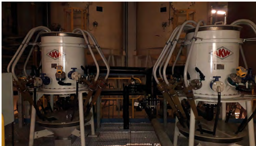
Fot. 5. Hydrocyklony ścieków
