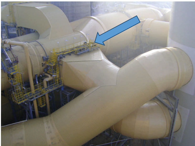
Fot. 11. Widok na klapę obejściową Absorbera C
