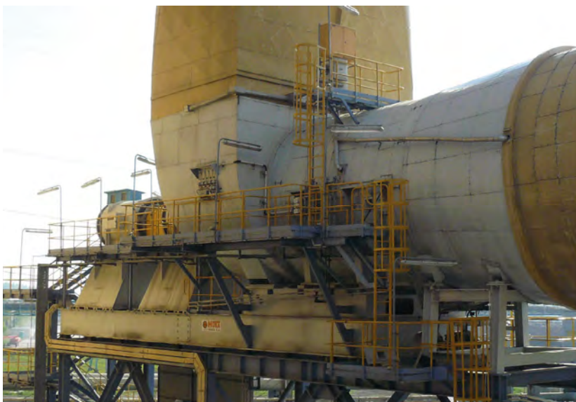
Fot. 9. Wentylator wspomagający (Booster Fan) absorbera D
