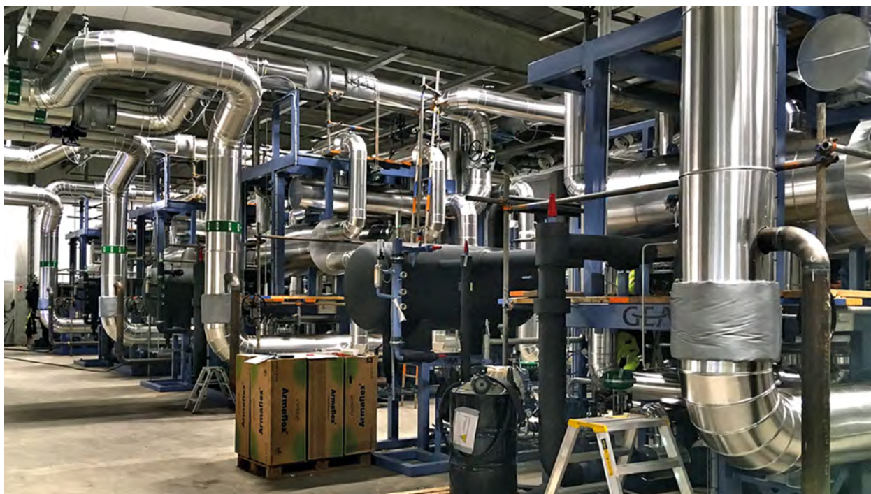
Instalacja amoniakalnych pomp ciepła GEA w przedsiębiorstwie E.ON w Malmö
