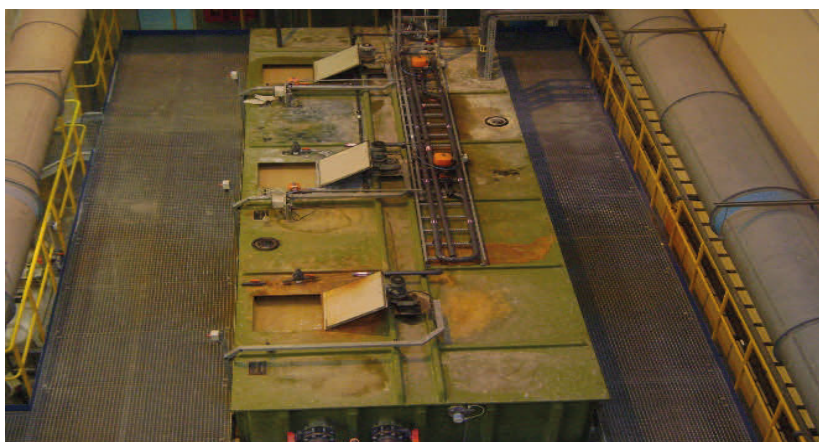
Fot. 6. Zbiornik reakcyjny na oczyszczalni ścieków
