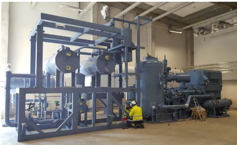
Amoniakalna pompa ciepła GEA w przedsiębiorstwie E.ON w Malmö
